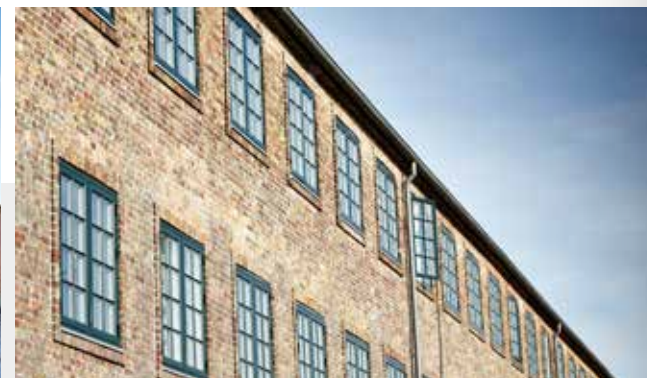
Hulgårdsvej, København NV. Vinduer til 46 lejligheder. Boligforening: Boligselskabet Hillerødhus Arkitekter: Botjek A/S Opført: 1922 Vinduer: VELFAC Classic
